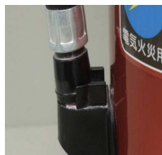
× 消火薬剤の漏れ
