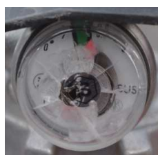
× 指示圧力計の損傷
